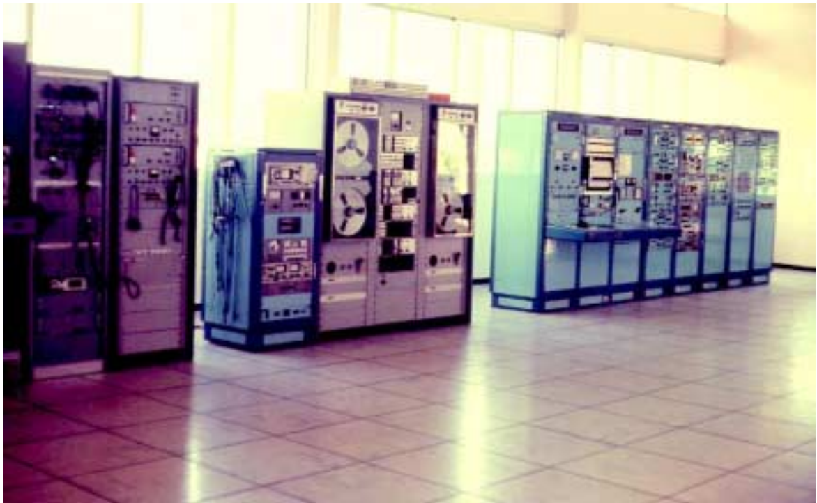
Figura 45 - Os equipamentos que constituíam a Estação de Rastreo de Fortaleza, montados nos bastidores.
